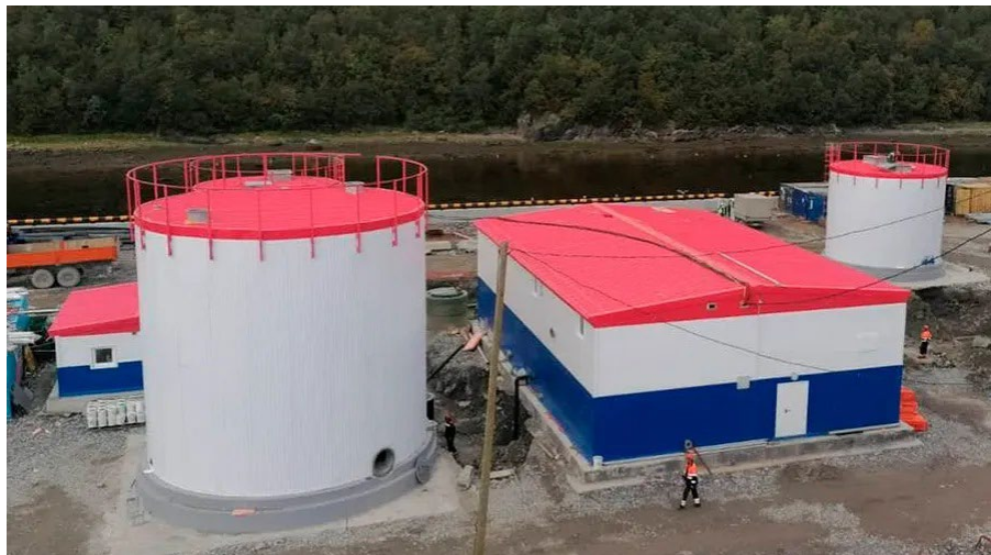
Общий вид смонтированных резервуаров
